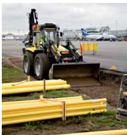
På Helsingfors-Vanda flygplats utfördes en ombyggnad av taxibanan. Flygtrafiken löpte väl trots byggarbetena.
