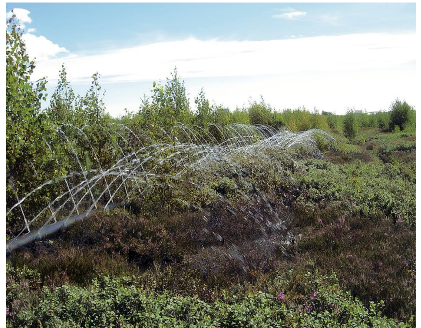
Pengerialtaiden toimintaa parannettiin keväällä 2008 rakentamalla kierrätysputket ja ejektorit, joilla osa vedestä voidaan kierrättää ja ilmastaa. Vesi hapettuu, kun se sadetetaan kiitoteiden välissä sijaitsevalle suoalueelle.
